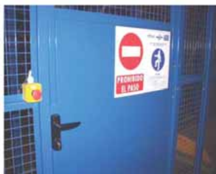
Puerta de acceso a un transelevador
