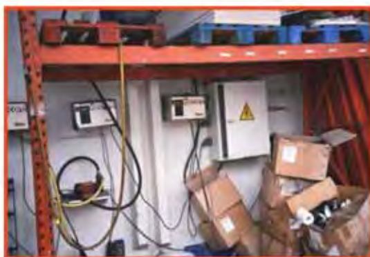
Ubicación inadecuada de los cargadores
