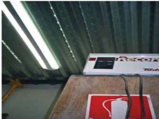
Cargador de carretilla elevadora en zona cerrada con iluminación no adecuada
