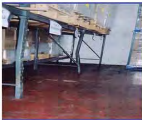
Puntales sin protección
