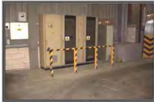
Ejemplo de protección de cuadros eléctricos contra golpes de los equipos automotores
