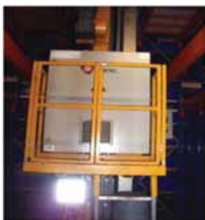
Puesto de operador de transelevador
