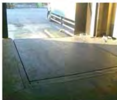
Sin delimitación de rampa de carga
